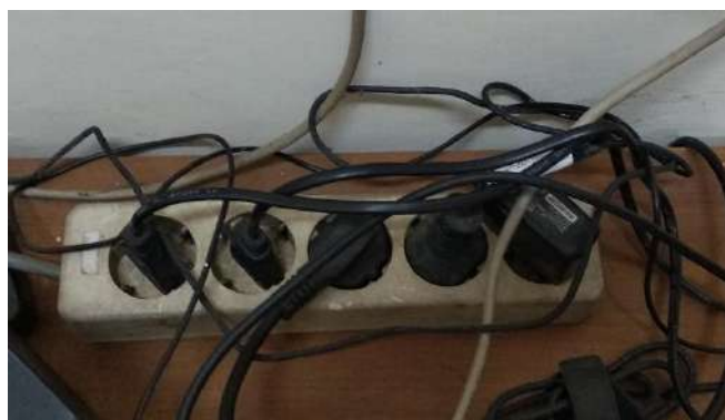
Gambar 57. kabel yang tidak teratur
